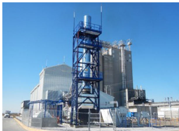
Planta de Cogeneración
